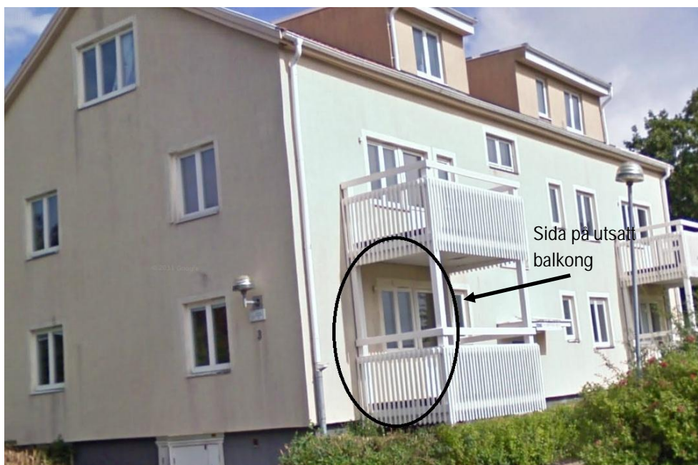
Figur 2. Befintligt bostadshus. Utsatt balkong med sida som behöver förses med bullerskydd är inringad.
