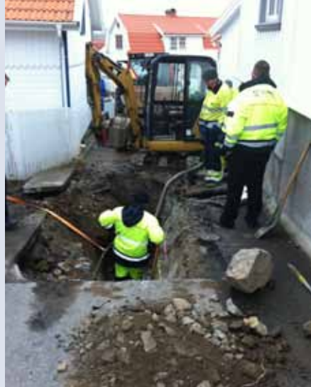
Jakt på läckor i vattenledningar på Klädesholmen.
